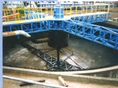
和歌山県/水処理装置
