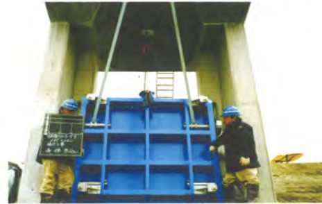
福島県/矢吹町 農業用水ゲート
